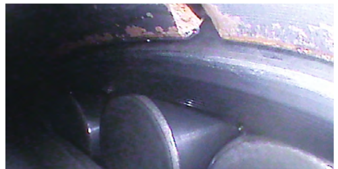
Schaden am Lagersitz
